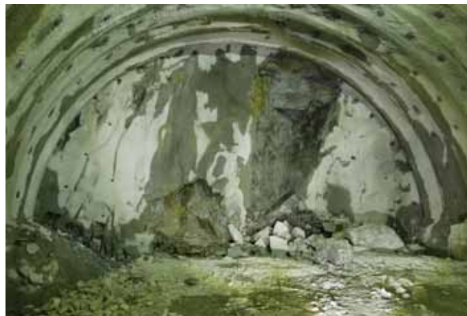
写真-2.2 切羽を正面から見た場合の崩落箇所を含む写真
