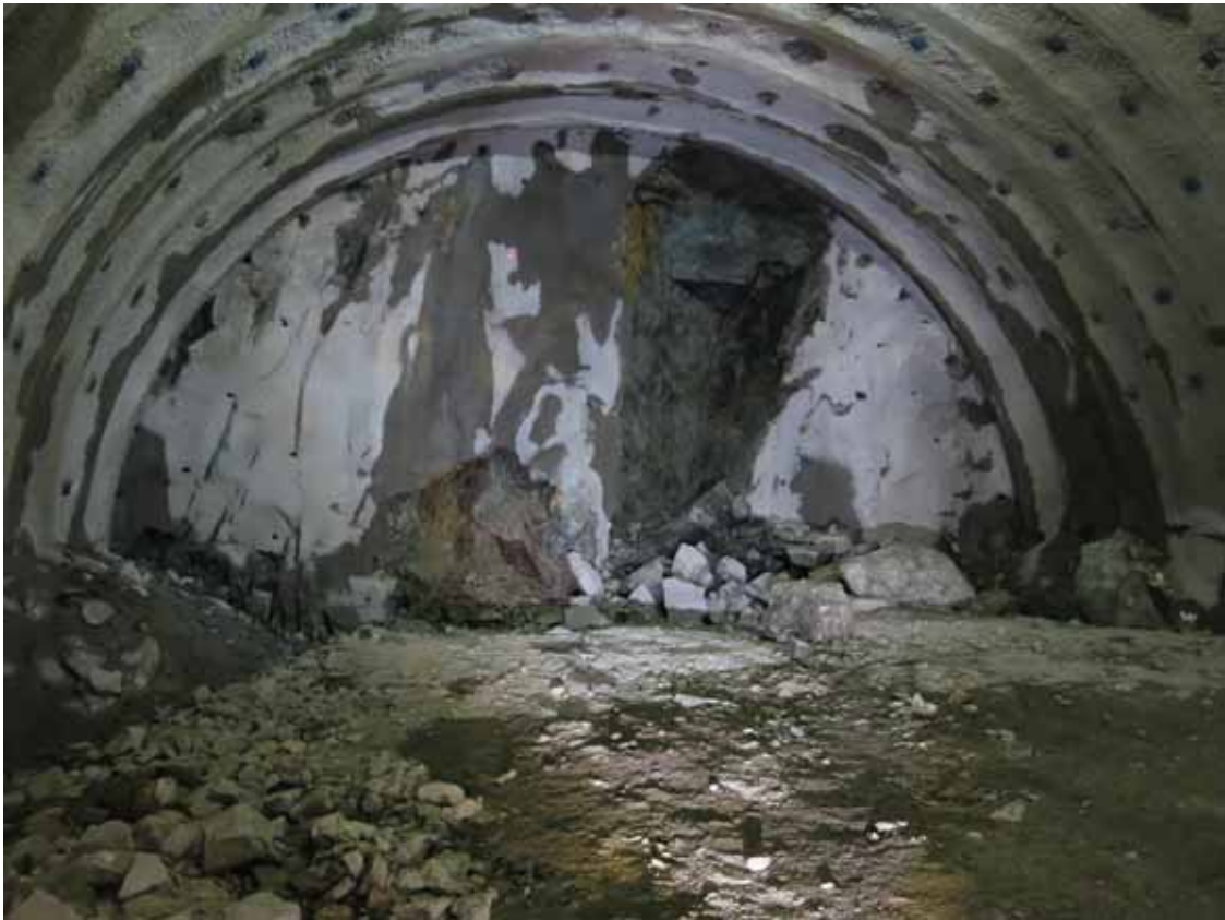
写真-1.1 当該災害現場の様子（正面に見えるのが切羽面であり，中央やや右側の剥落している箇所に存在していた岩塊が落下し，被災者に当たった。
