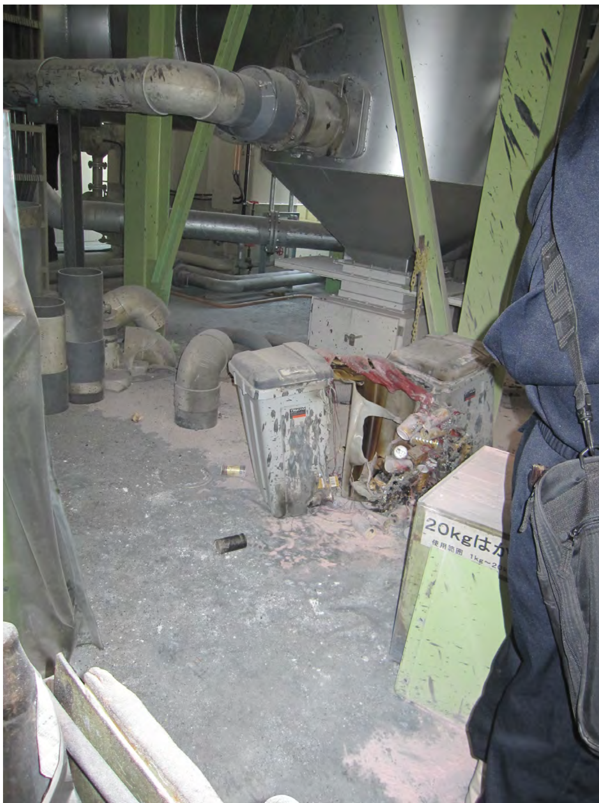
写真2 高温物によるプラスチック容器の溶損
