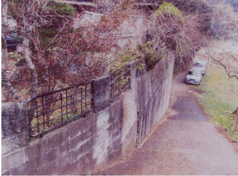
写真-2.2 既存のコンクリート擁壁の変状
