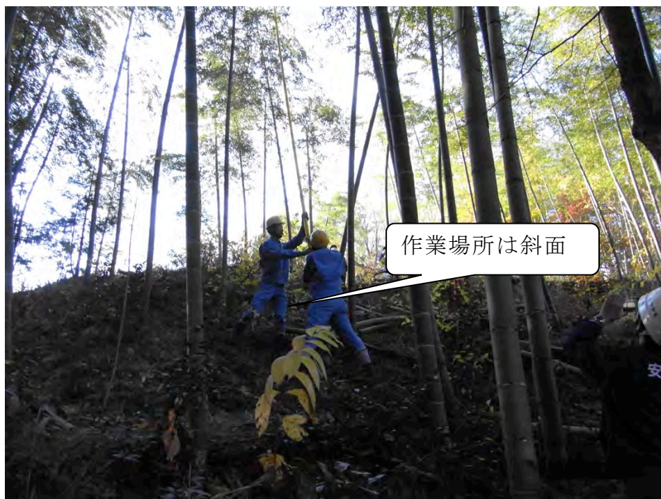
写真3 被災者が伐採しようとしていた青竹（絶縁棒で模擬）と作業場所の状況
