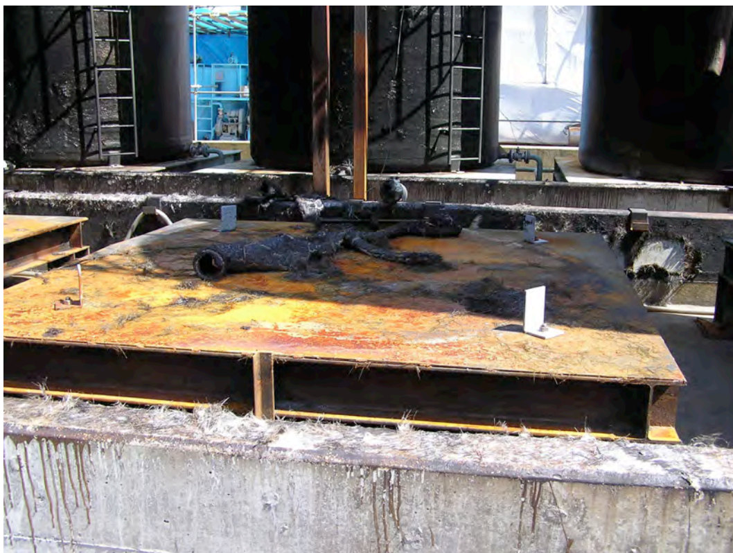
図 4: 飛ばされたタンクがあった周辺の焼損
