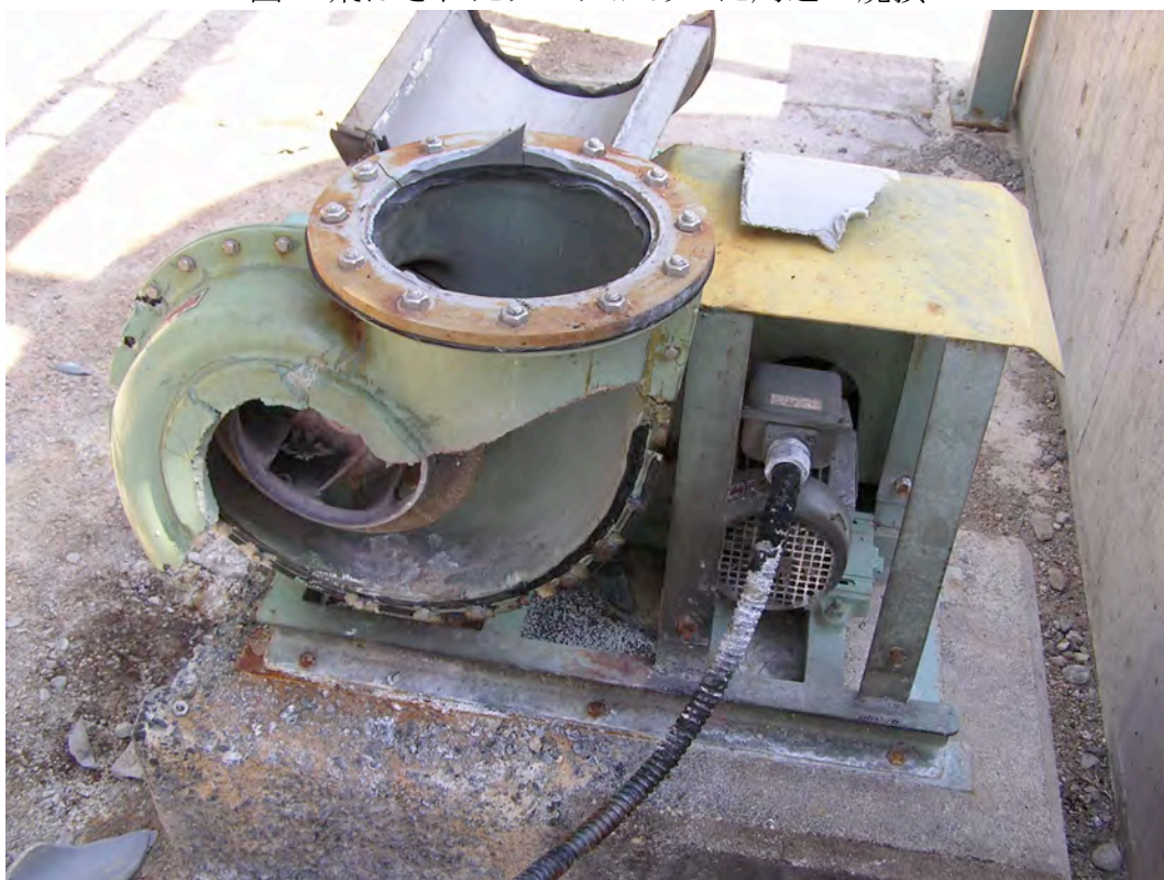
図 5: 破損した脱臭ファン
