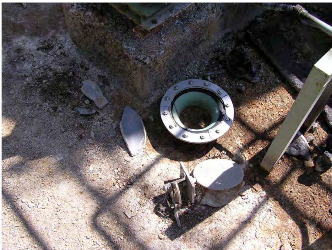
図 6:破損した脱臭ファンの配管・フランジ・ダンパ
