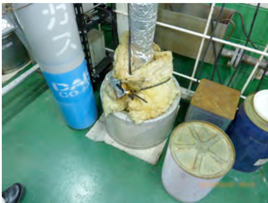
図 7 蒸留釜を覆う断熱材(グラスウール)
