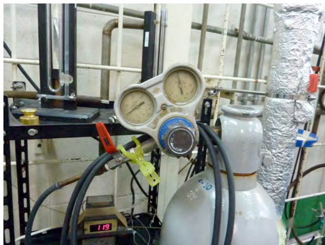
(a)蒸留塔そばの窒素ボンベ
