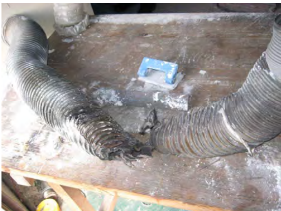
溶損した集じんホース
