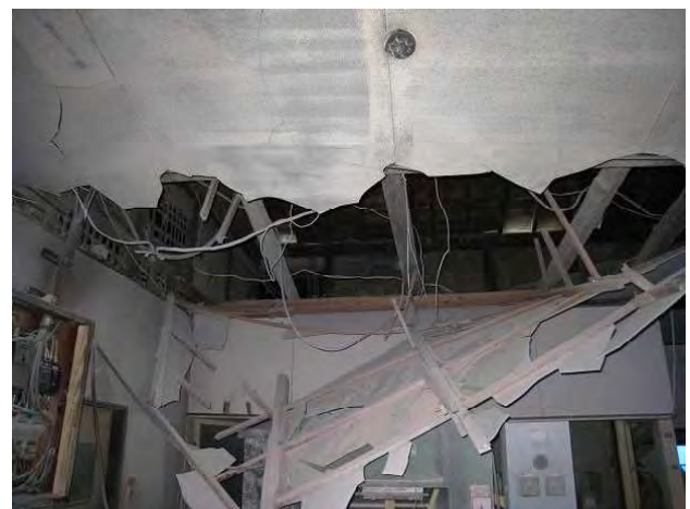
天井の一部が落下
