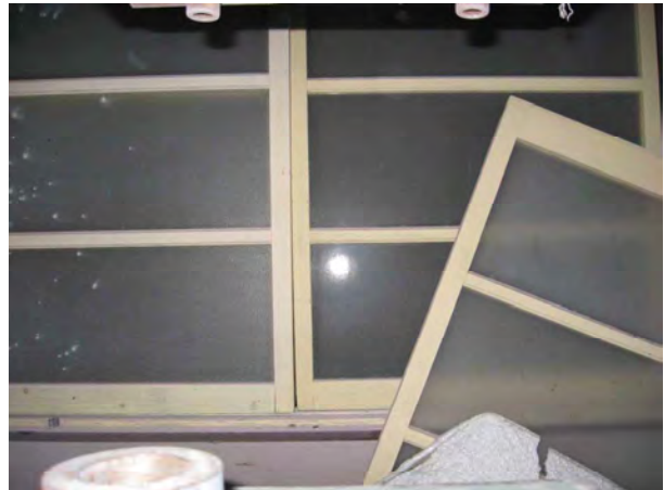
プレス機裏の窓ガラスは無事
