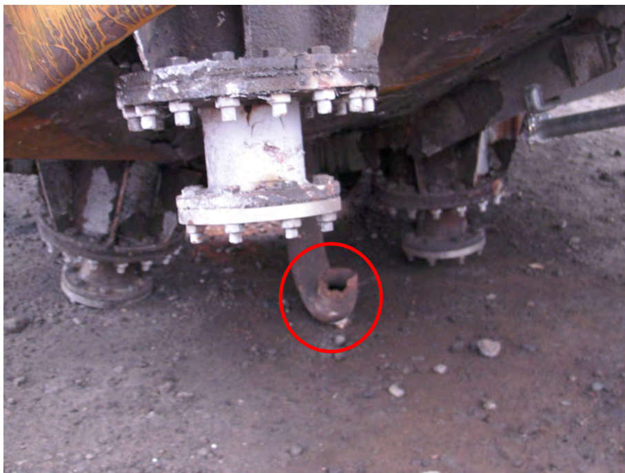
図7 044 タンク天板（本体から切れて別途飛散した。元の設置状態は上下反対）
