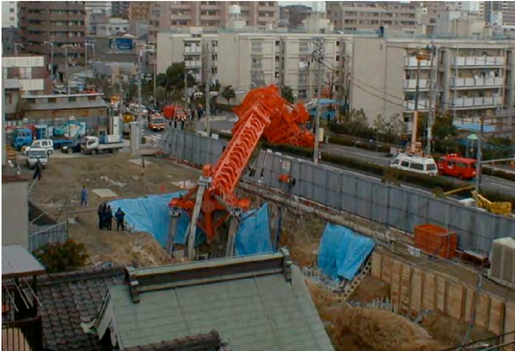
写真 1-1 転倒したクライミングクレーンを後方から見た様子
