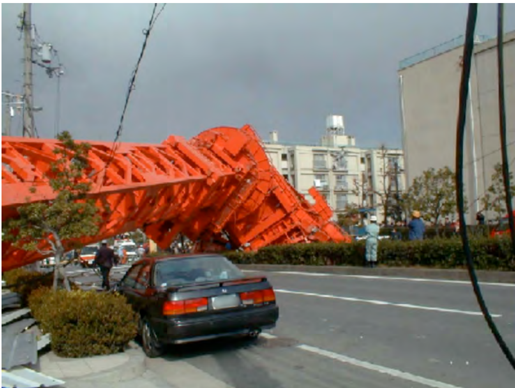
写真 1-2 転倒したクライミングクレーンが災害現場に隣接する 4 車線道路を覆った様子
