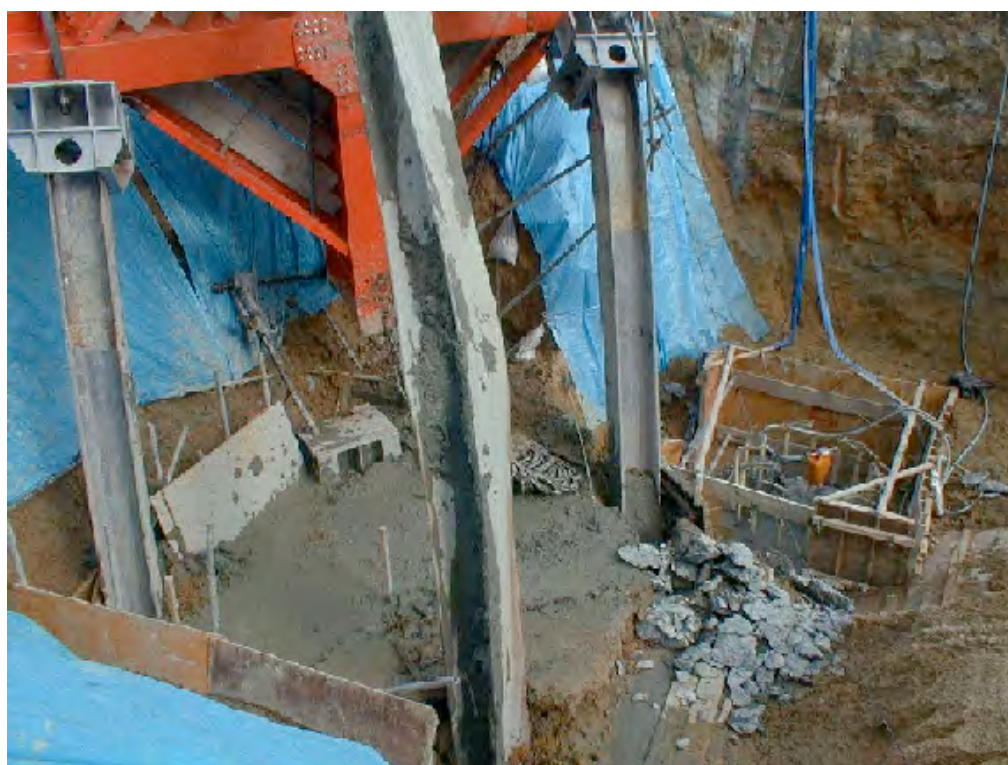
写真 3-1 杭基礎から引き抜けたH型鋼(手前側)とH型鋼が完全に埋没した様子(奥側)
