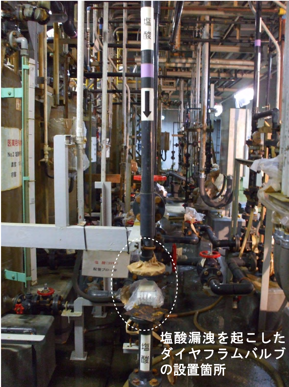
図 2. 2 漏洩災害を起こしたダイヤフラムが使用されていた現場の様子
