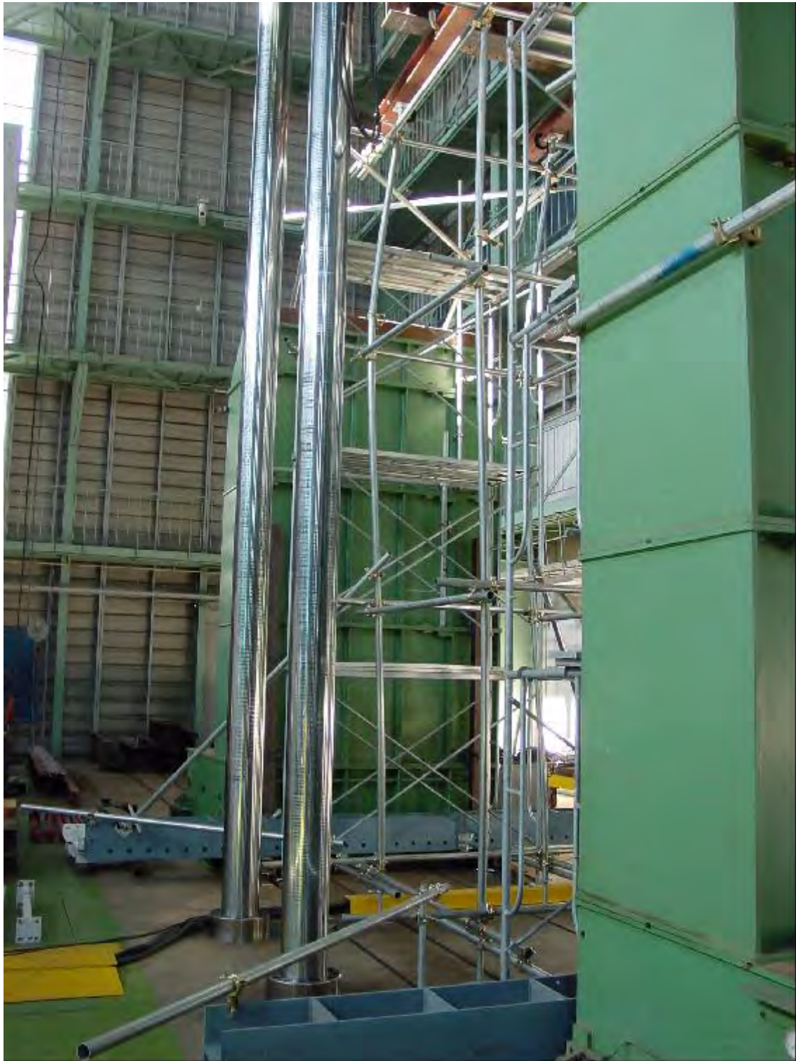
写真1-6 ケース3（3層足場、控えあり）の座屈形
