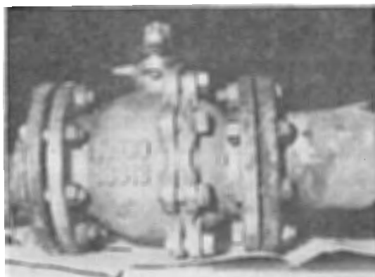
写真1 蒸留管ボールバルブ (左側-熱交へ、右側-処理槽へ)
