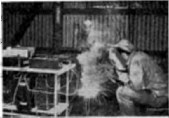
図 18 シャ断器の現地モニタ（負荷溶接機）
