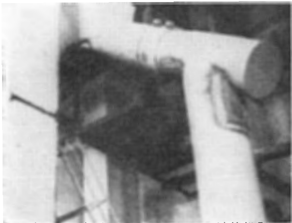
写真 3 点火源となったスパウトの溶接部分
