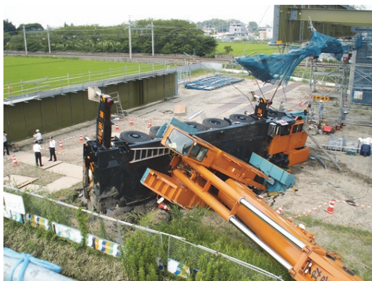
写真 2-1 転倒した大型の移動式クレーン
