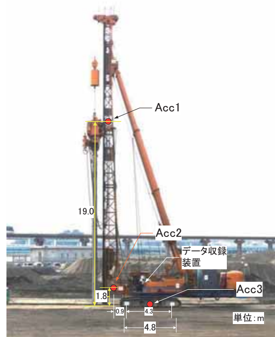
図 4-5-1 自走実験に使用したくい打機の外観と加速度計の設置位置
