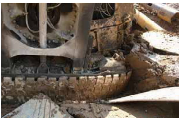
写真 2-2-3 沈下部周辺に見られた軟弱な地盤
