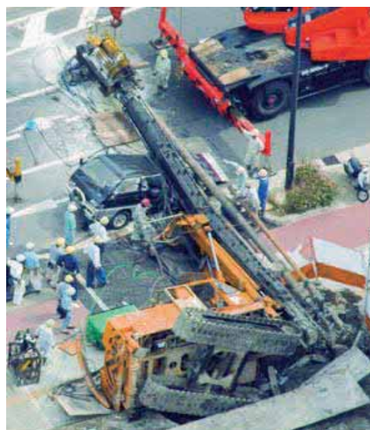
写真2-1-1 転倒したくい打機の様子
