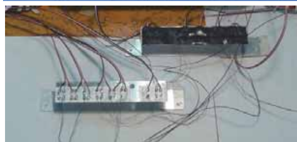
写真 5-2-4 筐体に内蔵する端子台と計測用延長ケーブル(上: 筐体に設置された端子台, 下: 2ゲージ法で接続したリード線と延長ケーブル)
