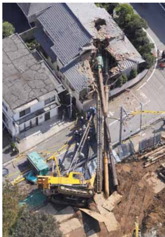
写真 2-2-1 転倒現場を上空から撮影した写真
