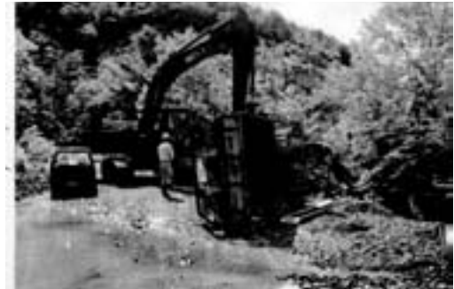
1) 積載形トラッククレーンの転倒
