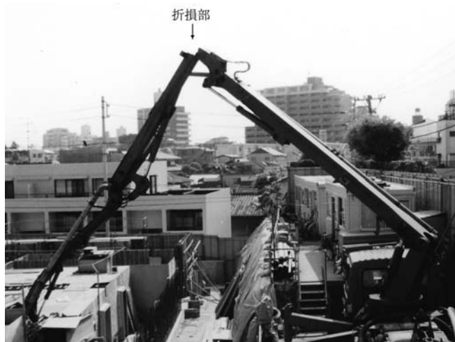
Photo 1 Complete view of the broken boom of the concrete pump truck. 折損したコンクリートポンプ車ブームの全景
