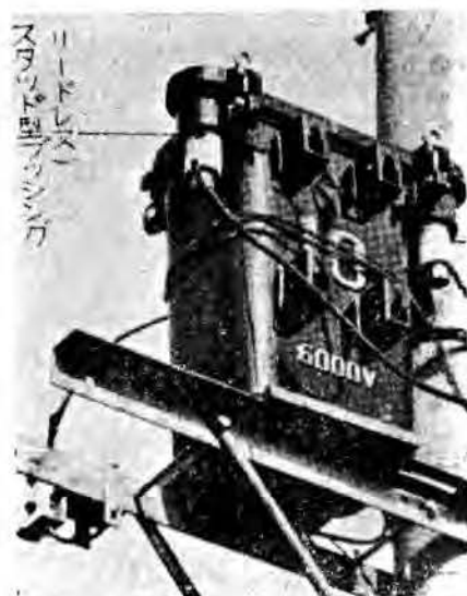
図4 変圧器スタッド型ブッシング
