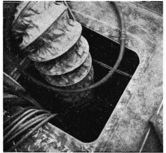
図14 マンホールに管を入れて換気している
