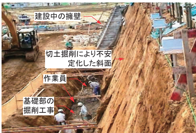
Fig. 2 Cutting works under unstable slope. 不安定な斜面に近接して実施される作業の例
