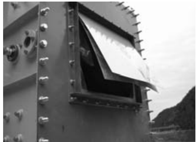
Photo11 Opened vent cover (after explosion) 開放した500 mm×600 mmベントカバー (爆発後)
