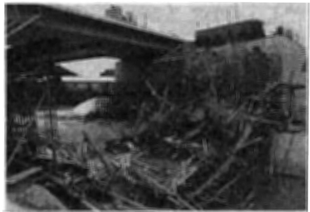
Photo 2 State of the collapsed girder type form shoring at the construction site of the motor car way in Okinawa. 沖縄自動車道建設工事における梁式型枠支保工の倒壊の状況
