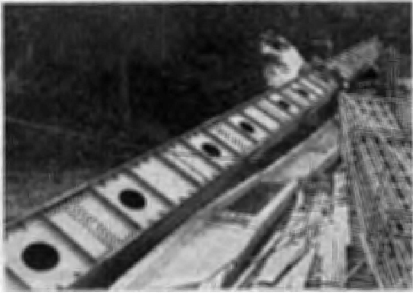
Photo 4 State of the collapsed temporary structure for the election girder at the railway construction site in Niigata. 鉄道架橋建設工事においてエレクションガーダを支えていた仮設支柱の倒壊の状況
