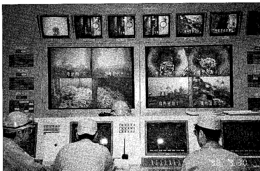
ある自治体の一般ごみ焼却炉中央管理室
