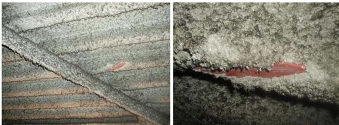
吹付けアスベスト(鉄骨耐火被覆材)
