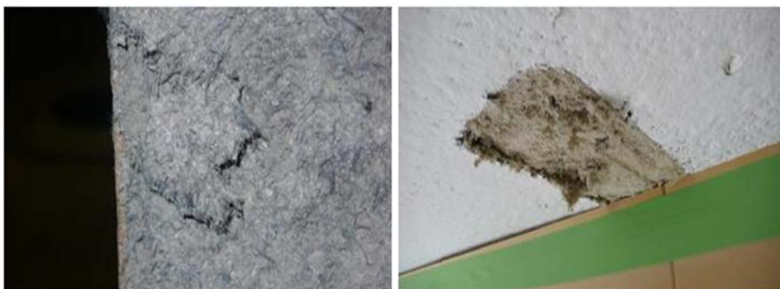
吹付けアスベスト(機械室吸音材)
