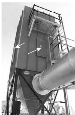
写真1 集じん機への設置例(矢印位置が爆発放散口)
