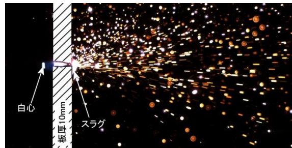
図1 切断部付近の火花の飛散状況
