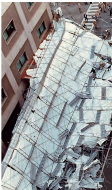
写真1 強風により倒壊した足場
