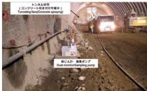
トンネル掘削現場における粉じん測定 Measurements of the dust concentration at a tunnel construction site.
